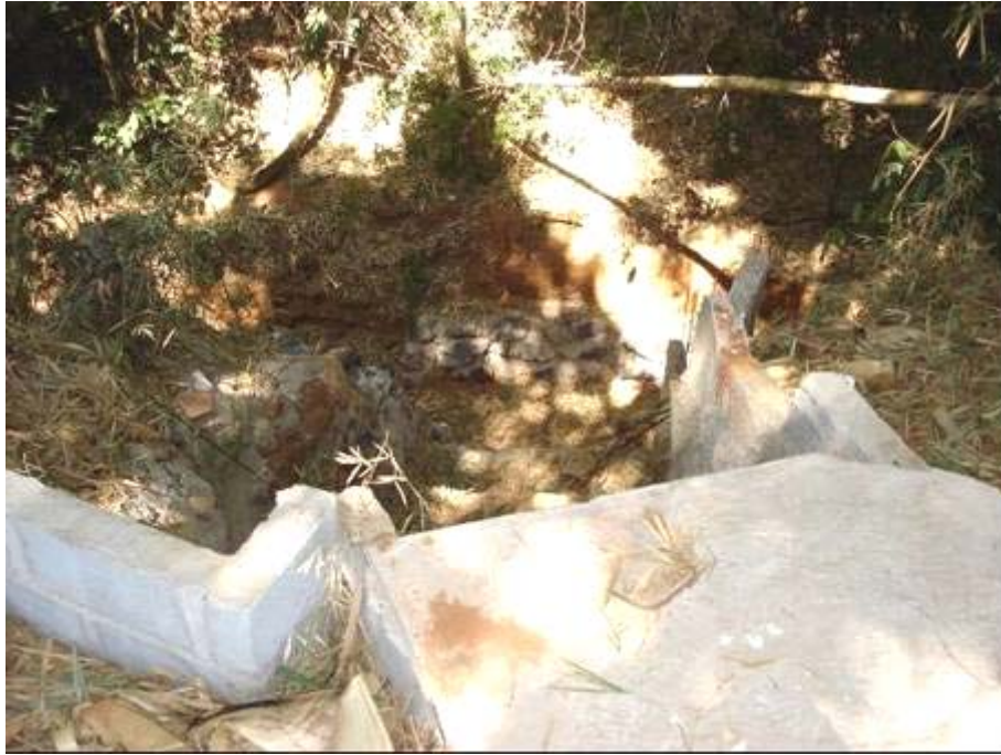
Figura 196 – Dissipador de Energia fora dos padrões da NOVACAP e insuficiente para inibir o aceleração de processos erosivos.
