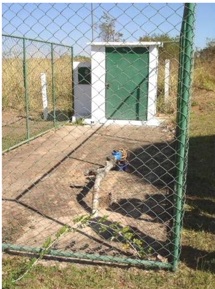
Figura 190 – Poço com Cerca de Proteção e Hidrômetro
