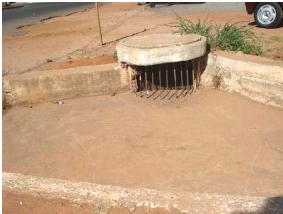
Figura 195 – Poço de Visita que também funciona como Boca de Lobo (Fato Inadequado).
