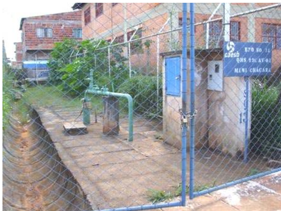
Figura 191 – Poço Próximo de Edificações
