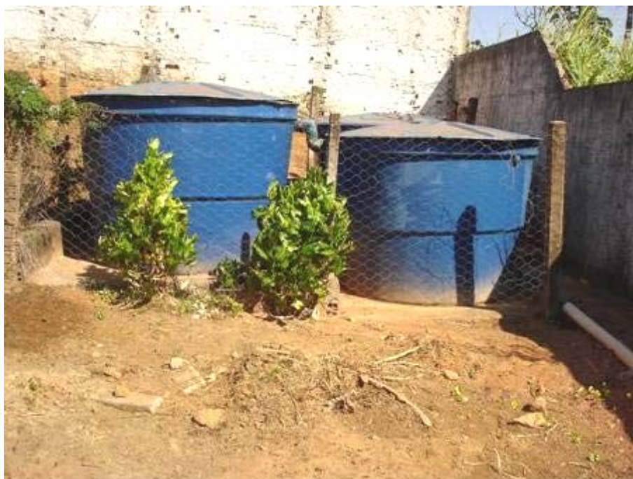
Figura 193 – Tanques para Tratamento de Esgotos
