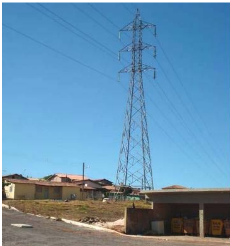
Figura 201 – Torre de Linha de Transmissão de Energia Elétrica.
