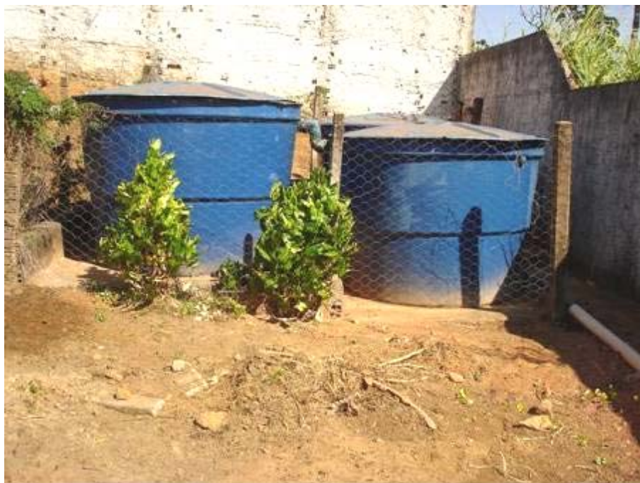
Figura 49 – Tanques para Tratamento de Esgotos.
