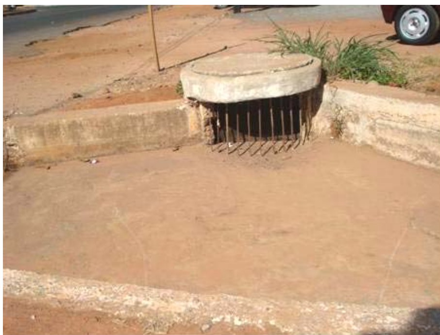
Figura 50 – Poço de Visita que também funciona como Boca de Lobo (Fato Inadequado).
