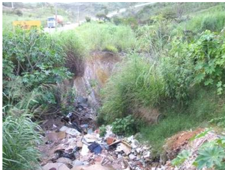
Figura 52 – Ravinas de grandes dimensões com acúmulo de resíduos sólidos urbanos.
