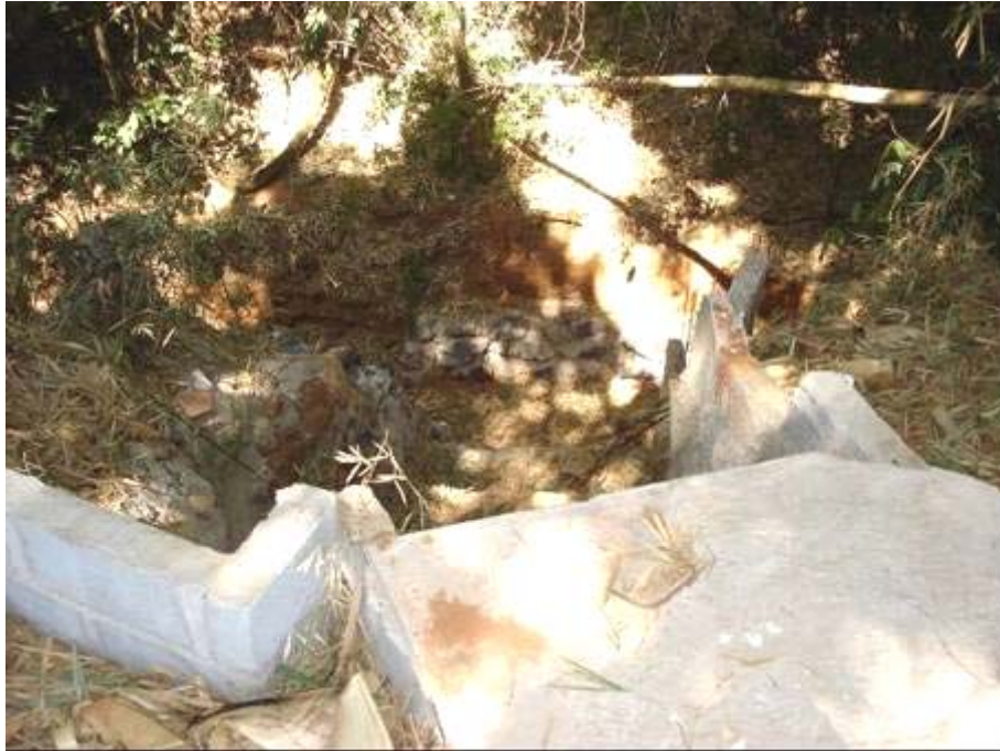
Figura 51 – Dissipador de Energia fora dos padrões da NOVACAP e insuficiente para inibir o aceleração de processos erosivos.
